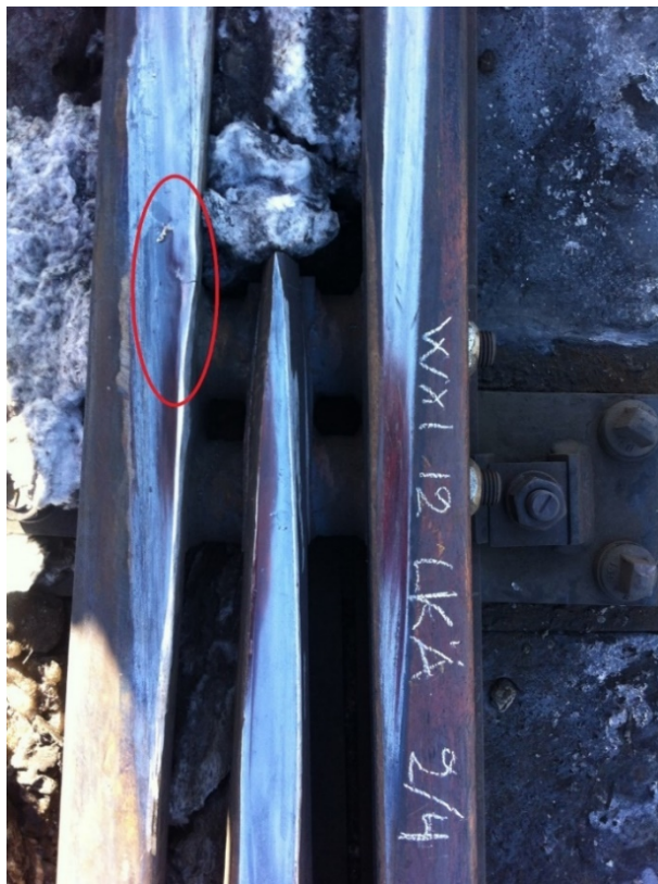
Bild 5 Exempel: Tvärspricka vingräl, materialbortfall inom kort.- Akut
