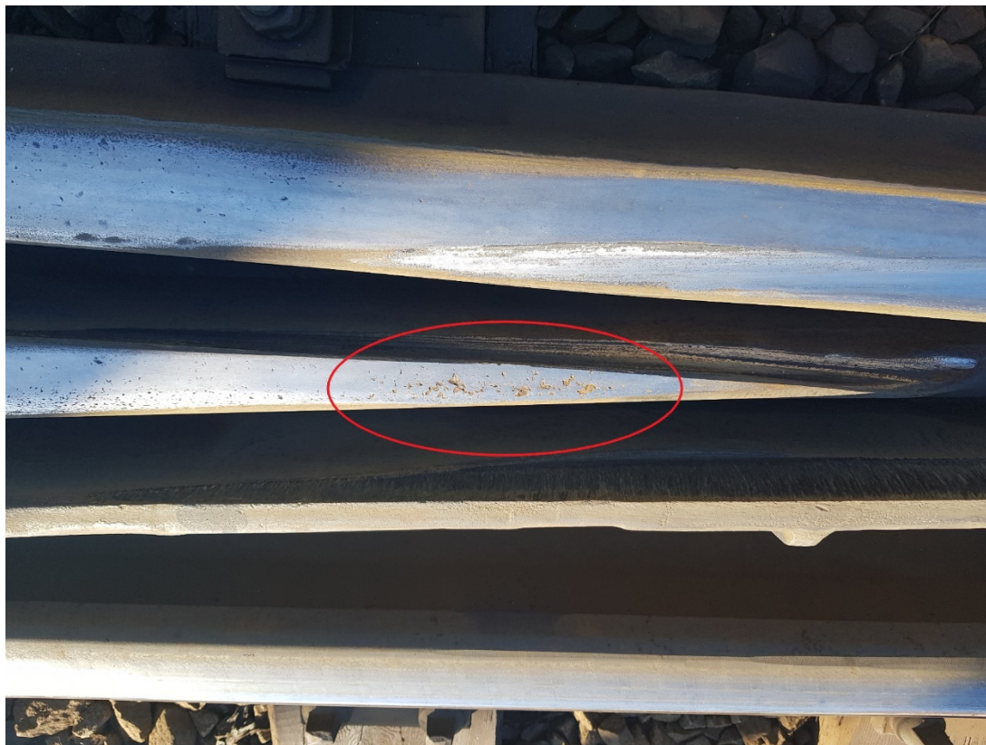
Bild 16 Exempel: Små defekter på korsningspets. - M
