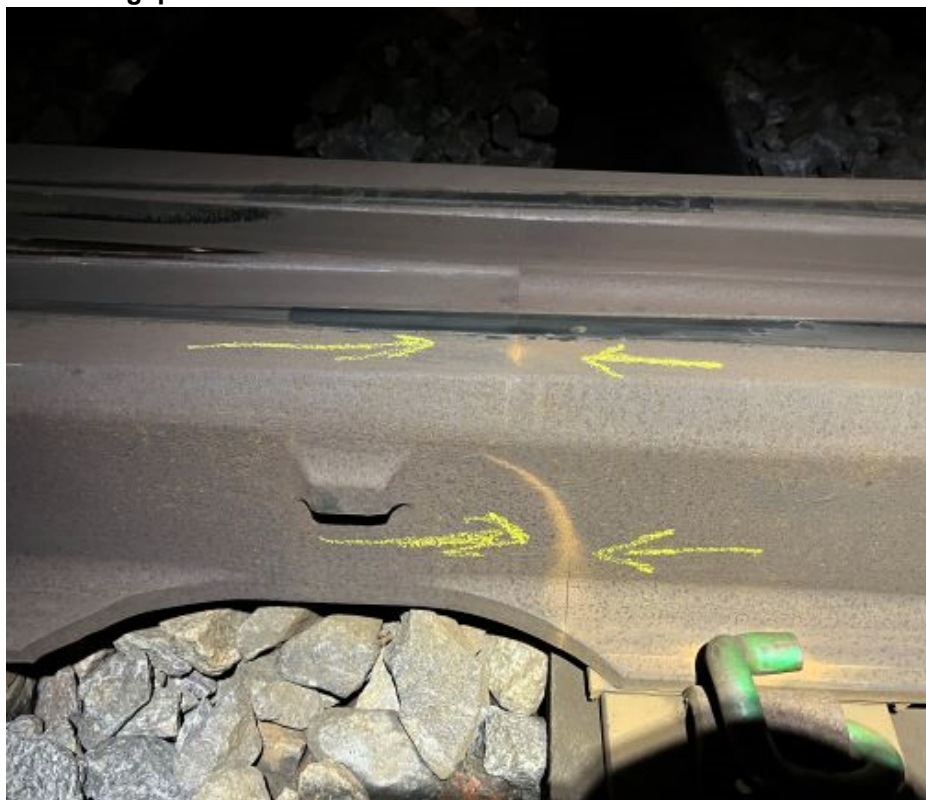
Bild 4 Exempel: Spricka upp från foten på korsningen. - Akut
