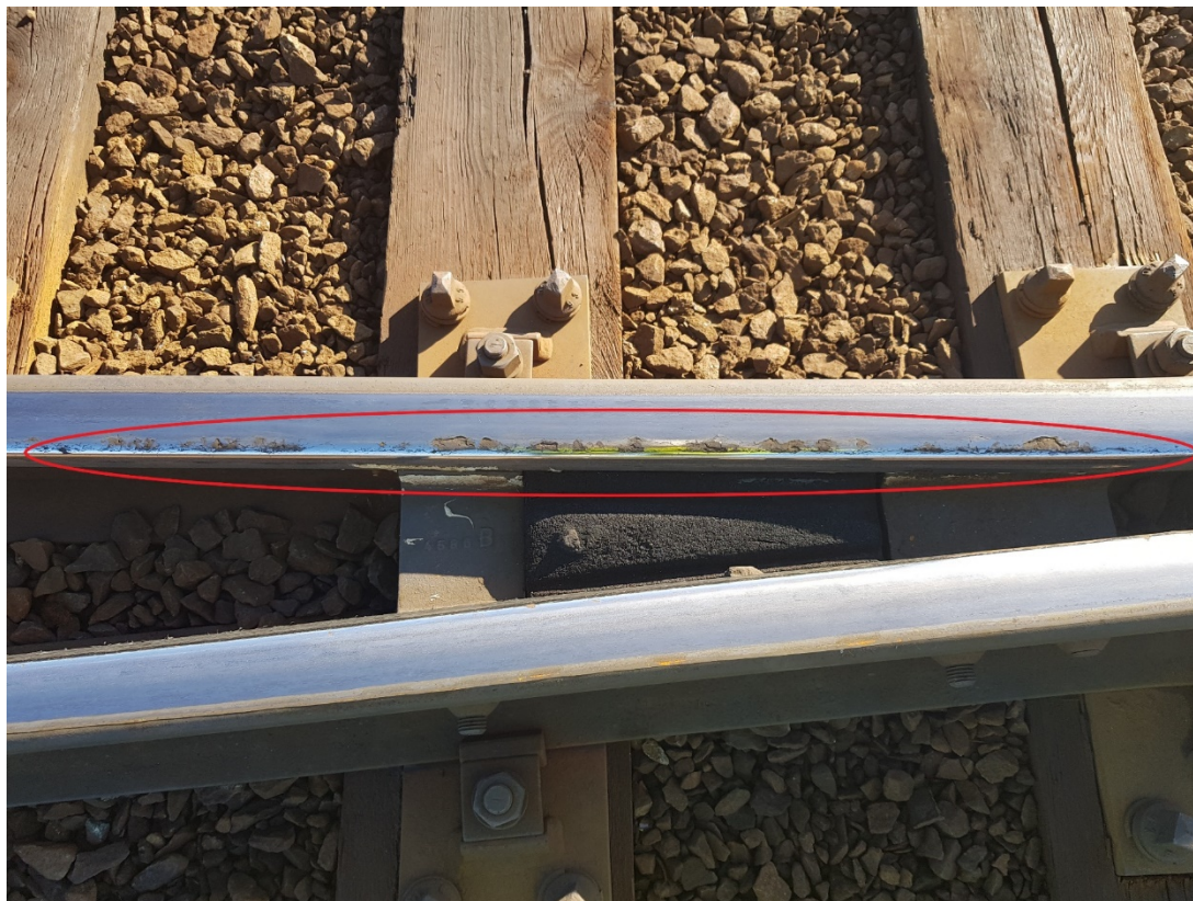
Bild 15 Exempel: Farkantsprickor där material släppt. - M
