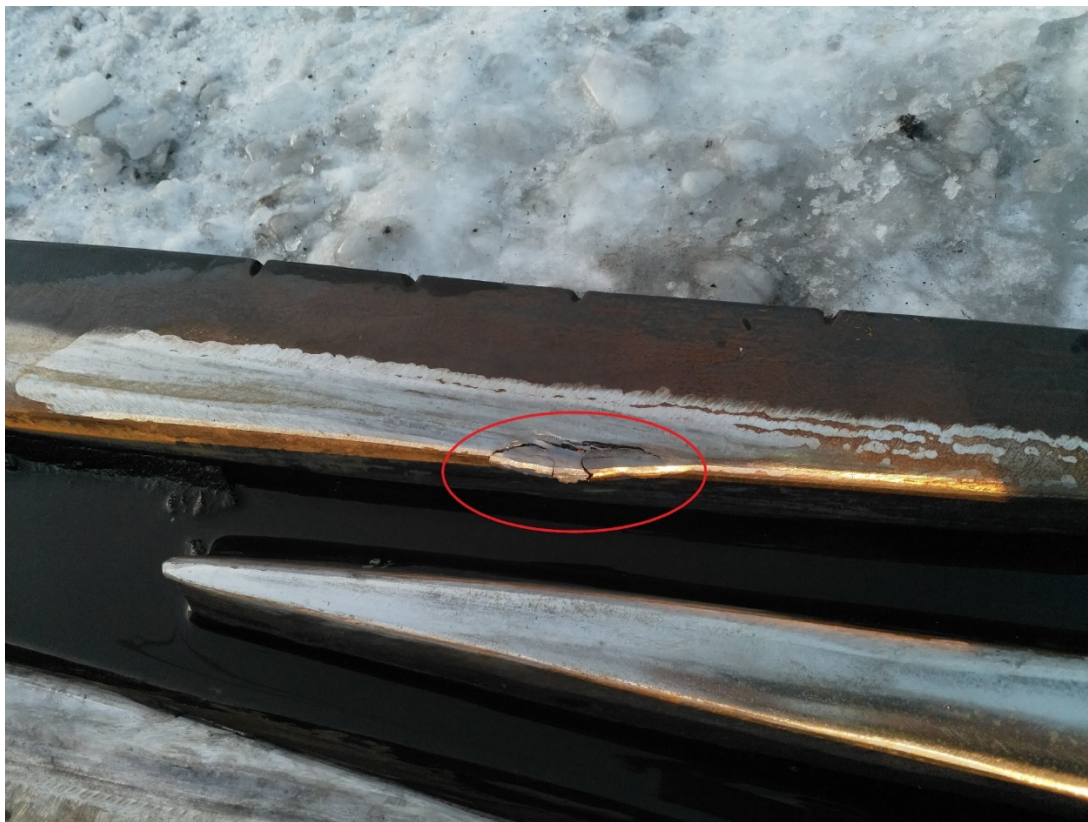
Bild 6 Exempel: Sprickor vingräl, material håller på att lossna. - Akut
