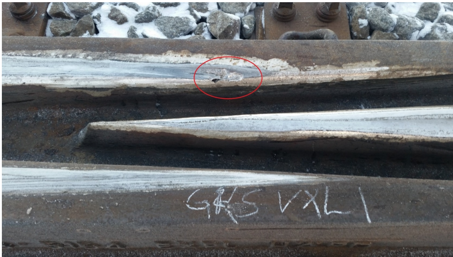
Bild 11 Exempel: Mindre skada på vingräl. - V
